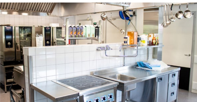
Dingle förskola har även utrustats med ett nytt ergonomiskt tillagningskök och större förvaringsutrymmen.
