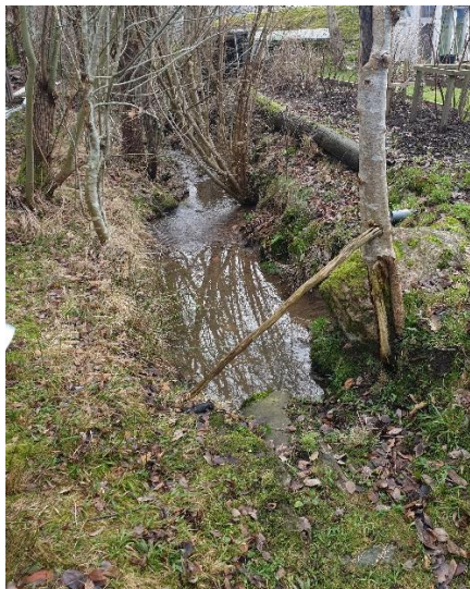
Figur 12 Nedre delen av avledningstråk mellan fastigheterna runt Södervägen. Stråket fortsätter ner längs bergskanten mot Saltkällefjorden.
