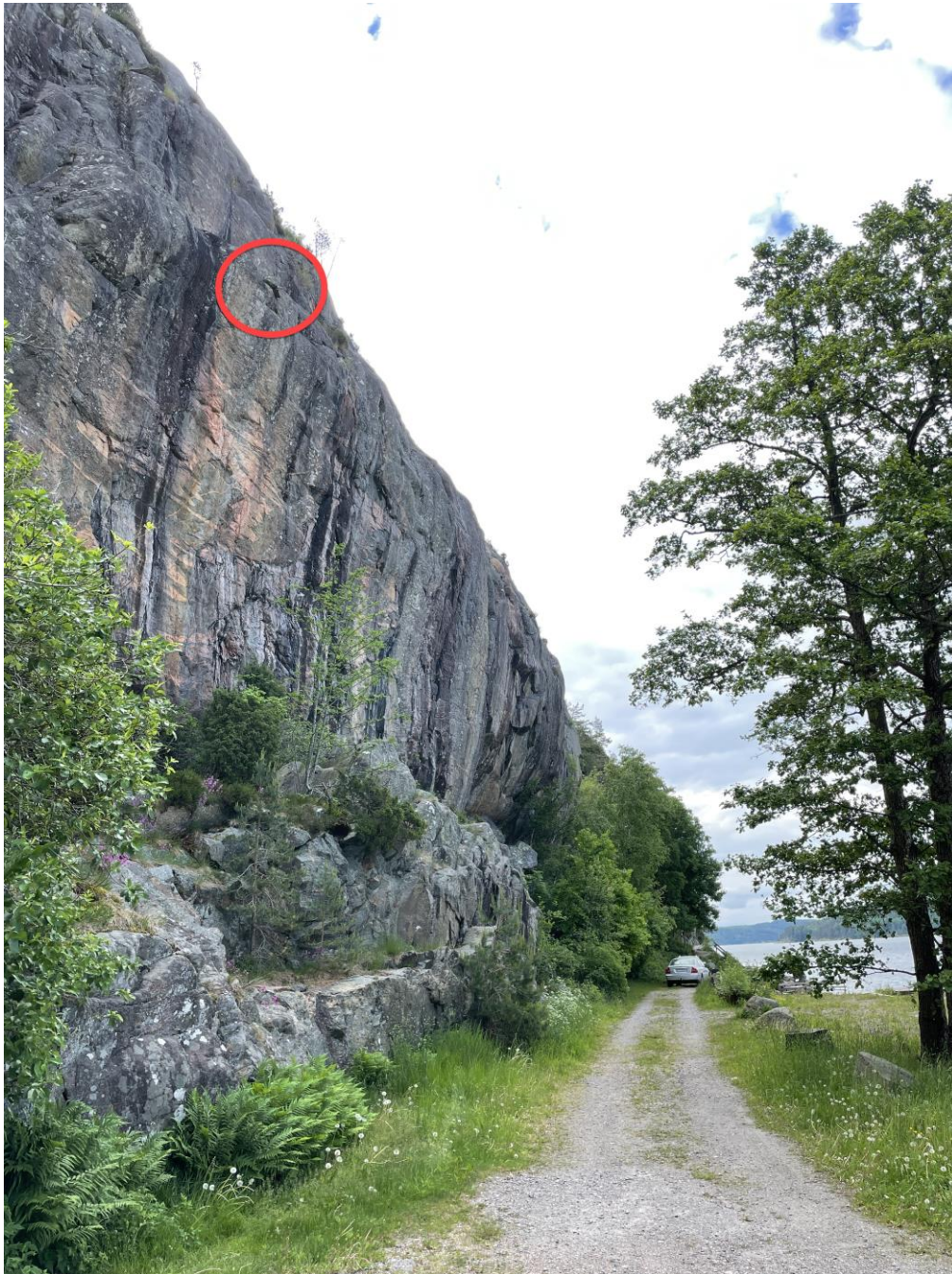
Figur 6. Bergväggen längs med Gårviksvägen, strax söder om detaljplanen. Instabil sten inringad på bergväggens krön inringad med röd cirkel.
