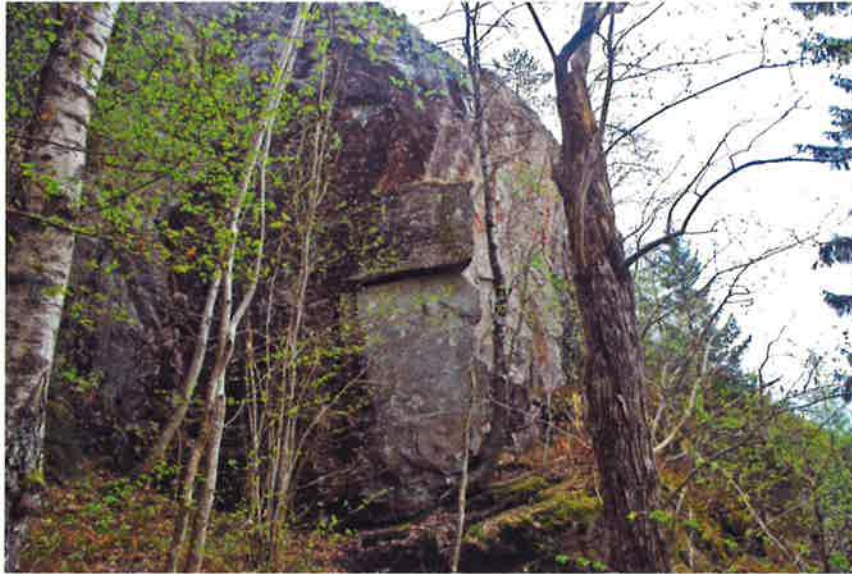
Figur 20. Stort löst block vilandes på svagt inåtlutande klippavsats. Klippavsatsen på vilket blocket vilar på är även det uppsprucket vilket kan innebära låg stabilitet. Fastighet 3:26 ligger i nära anslutning. Vy mot söder (Foto ID=48).
