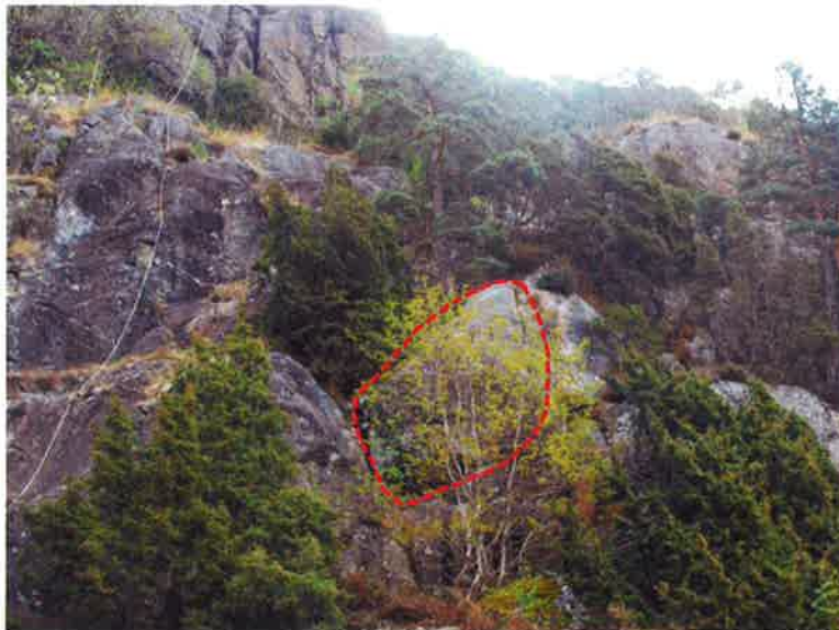
Figur 16. Mellan bostäderna på fastighet 3:3 finns ett eventuellt lösgjort block om ca 2*3 m, 5 m upp i brant bergslänt. Oklar blocksäkerhet, tallen som växer i sprickan kan på sikt skapa instabilitet. Fördjupad utredning är lämplig (Foto ID=8).
