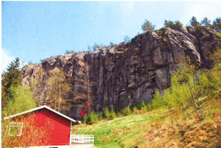
Figur 13. Vertikala bergväggar i södra delen av området. Löst block syns vid släntfoten bakom hustaket. Fastighet 3:45. Vy mot nordost (Foto ID=67).
