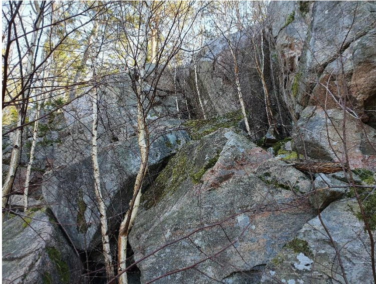
Bergslänt 4, större block och vegetation längre söderut i slänten. Vy mot norr.
