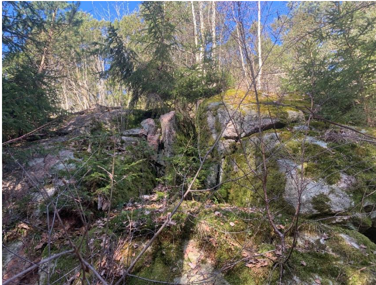
Bergslänt 5, ett fåtal lösa block i slänten. Vy mot öst.
