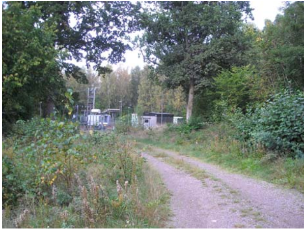
Foto 7. Transformatorstation/ställverk i sydost
