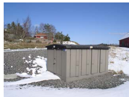
Befintlig transformator vid Dalevägen
